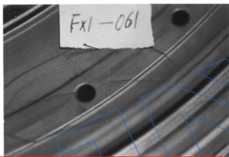
图2 修理中发现的孔边裂纹
